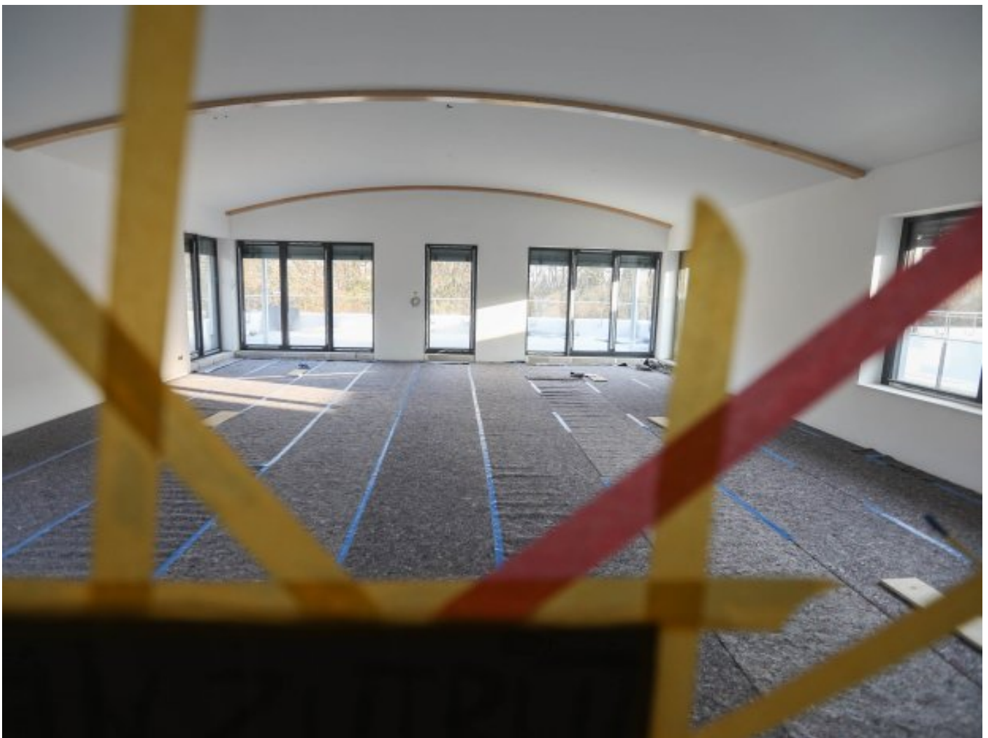
Noch Baustelle, bald modernes Coworking-Space: das „64 Grad Nord“ im Oberhausener Gewerbegebiet im Erlengrund. Foto: Michael Dahlke / FUNKE Foto Services
